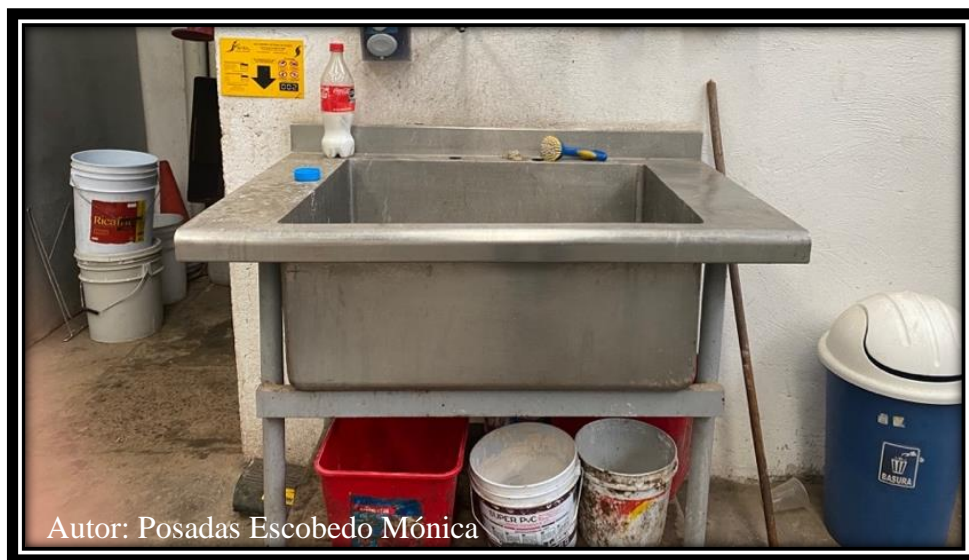
Figura n. ° 13 Área sin rótulos de lavado de manos
